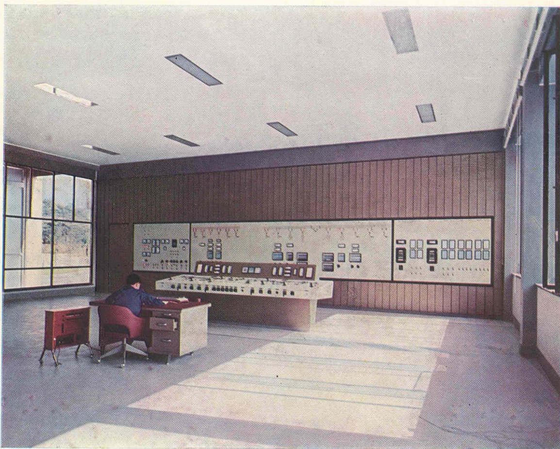
Fig. 52 - SALA QUADRI — Gli alternatori sono rigidamente collegati con due trasformatori le cui uscite fanno capo ad un doppio sistema di sbarre che alimenta le due linee a 150 kW e i due trasformatori per l'alimentazione delle utenze locali.
