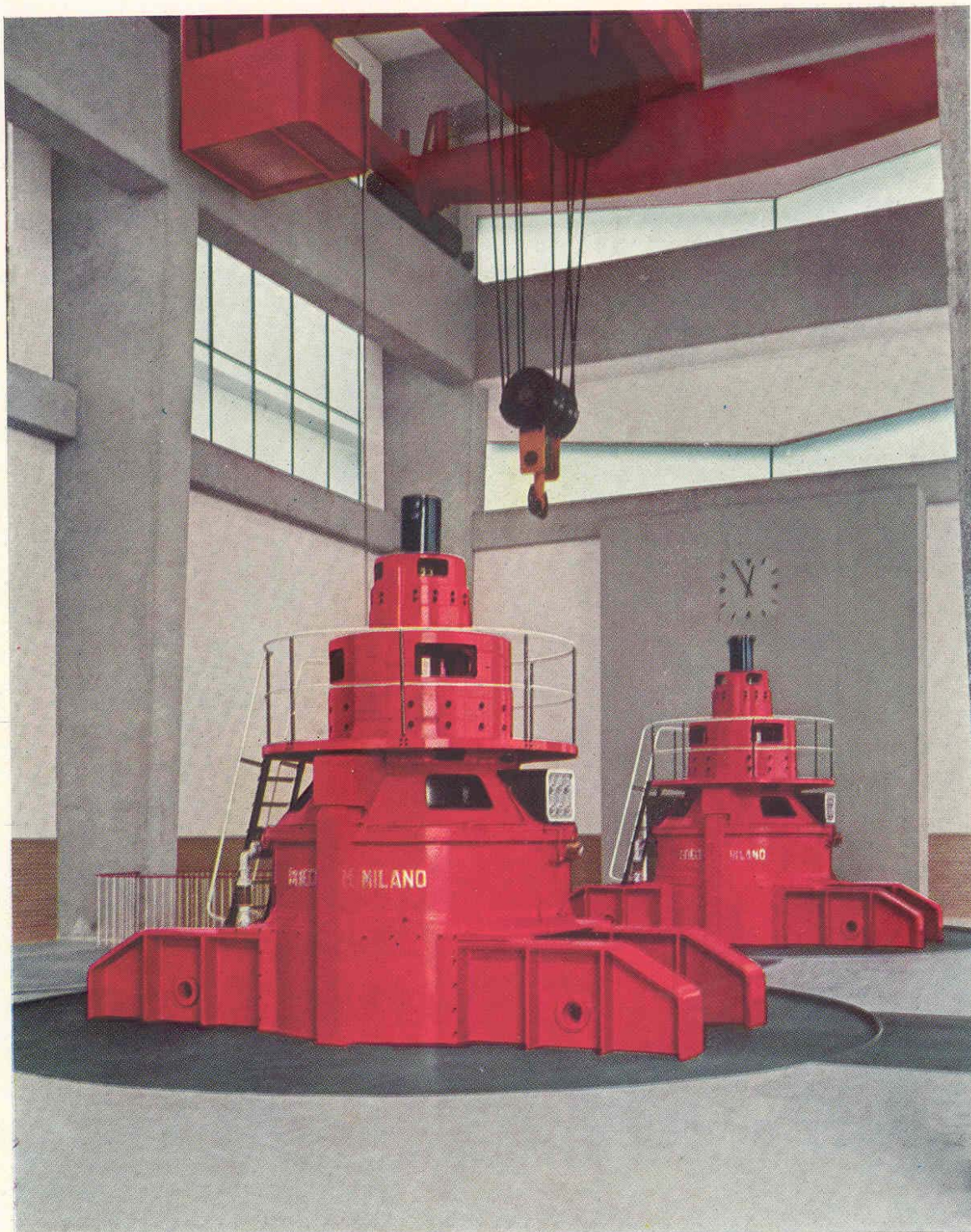
Fig. 49 - CENTRALE DI S. ANGELO — Interno della sala macchine.
