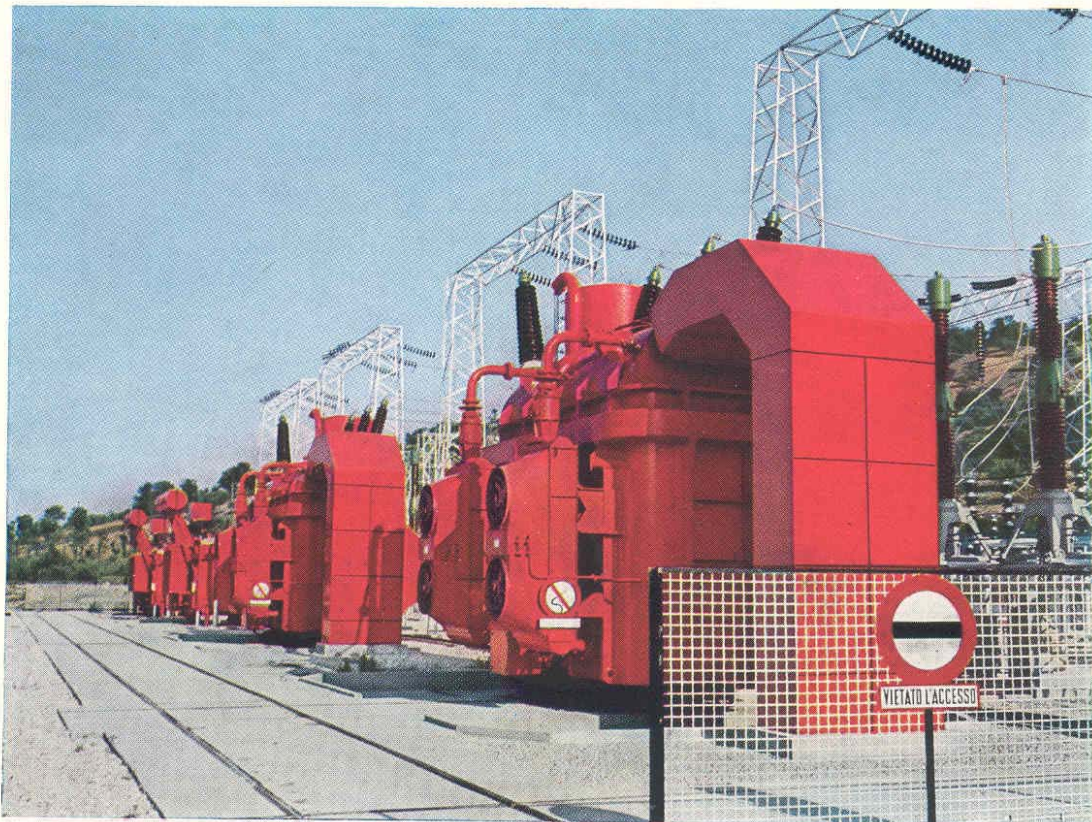
Fig. 54 - STAZIONE DI TRASFORMAZIONE — Sono installati due trasformatori elevatori 9,2/150 kW da 37 MVA e due trasformatori 150/30/8,4 kV da 4/4/1 MVA per l'alimentazione dei servizi ausiliari e delle utenze locali.
